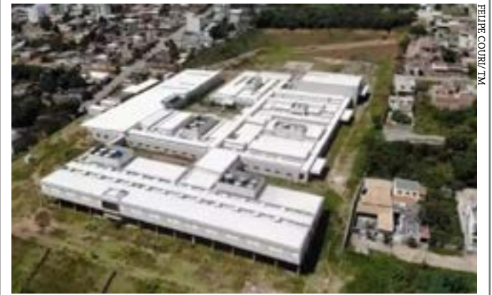
Secretário de Estado de Saúde explicou que atualmente as obras estão em parte de revisão de janelas e telhado
